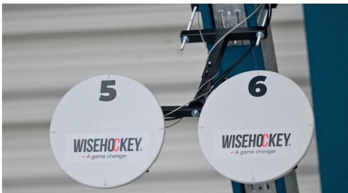
Circa zwanzig Empfänger wurden unter dem Hallendach montiert.
